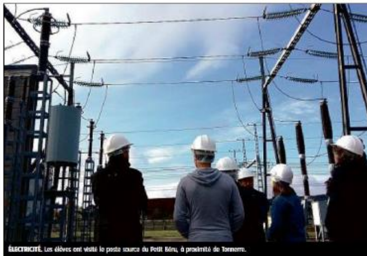
ÉLECTRICITÉ. Les élèves ont visité le poste source du Petit Béru, à proximité de Tonnerre.
